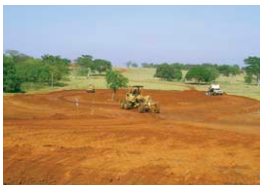
Local próximo à estação ferroviária de Andradina em obras para a construção de terminal de transporte de álcool
