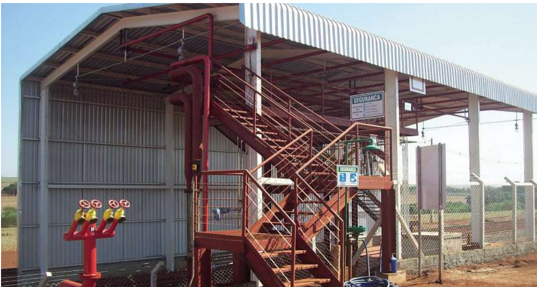
Nova estrutura para carregamento ferroviário de etanol na Usina da Pedra
