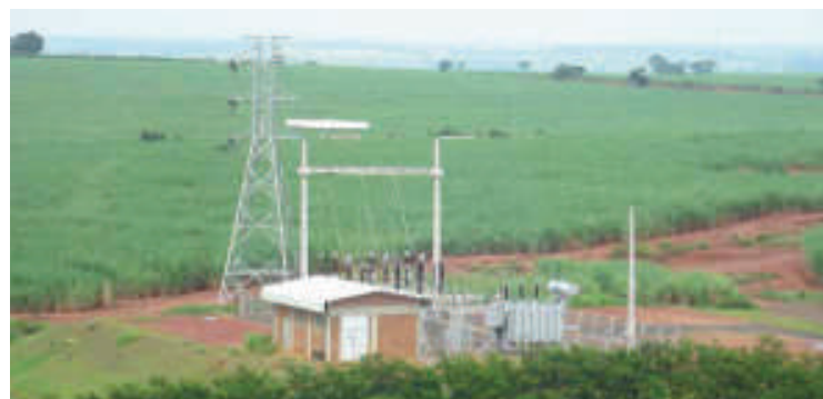
Subestação de energia na Usina Ipê: obras começaram ainda em safra
