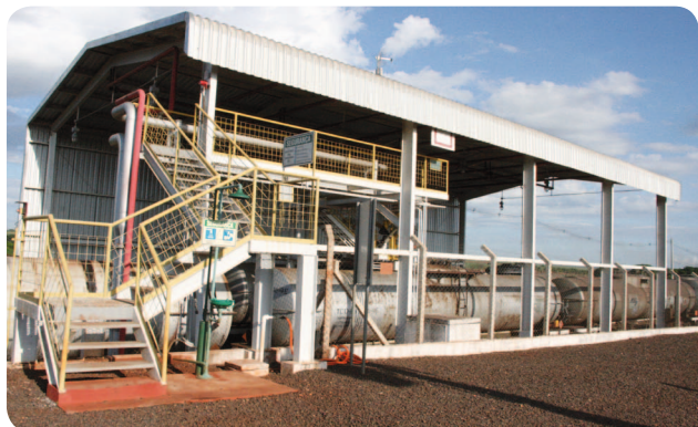
Terminal ferroviário instalado na Usina da Pedra
