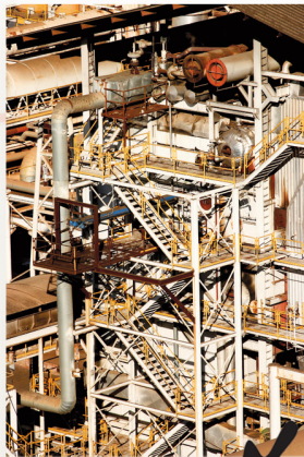
O vapor é gerado dentro das caldeiras
