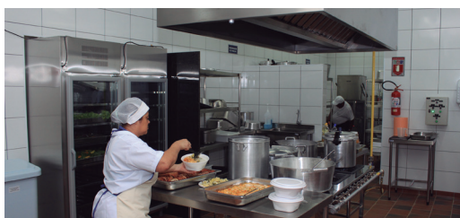
Cozinha industrial do novo refeitório
