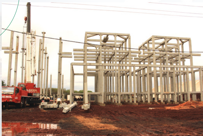
Local das futuras torres de resfriamento de água, na Usina da Pedra
