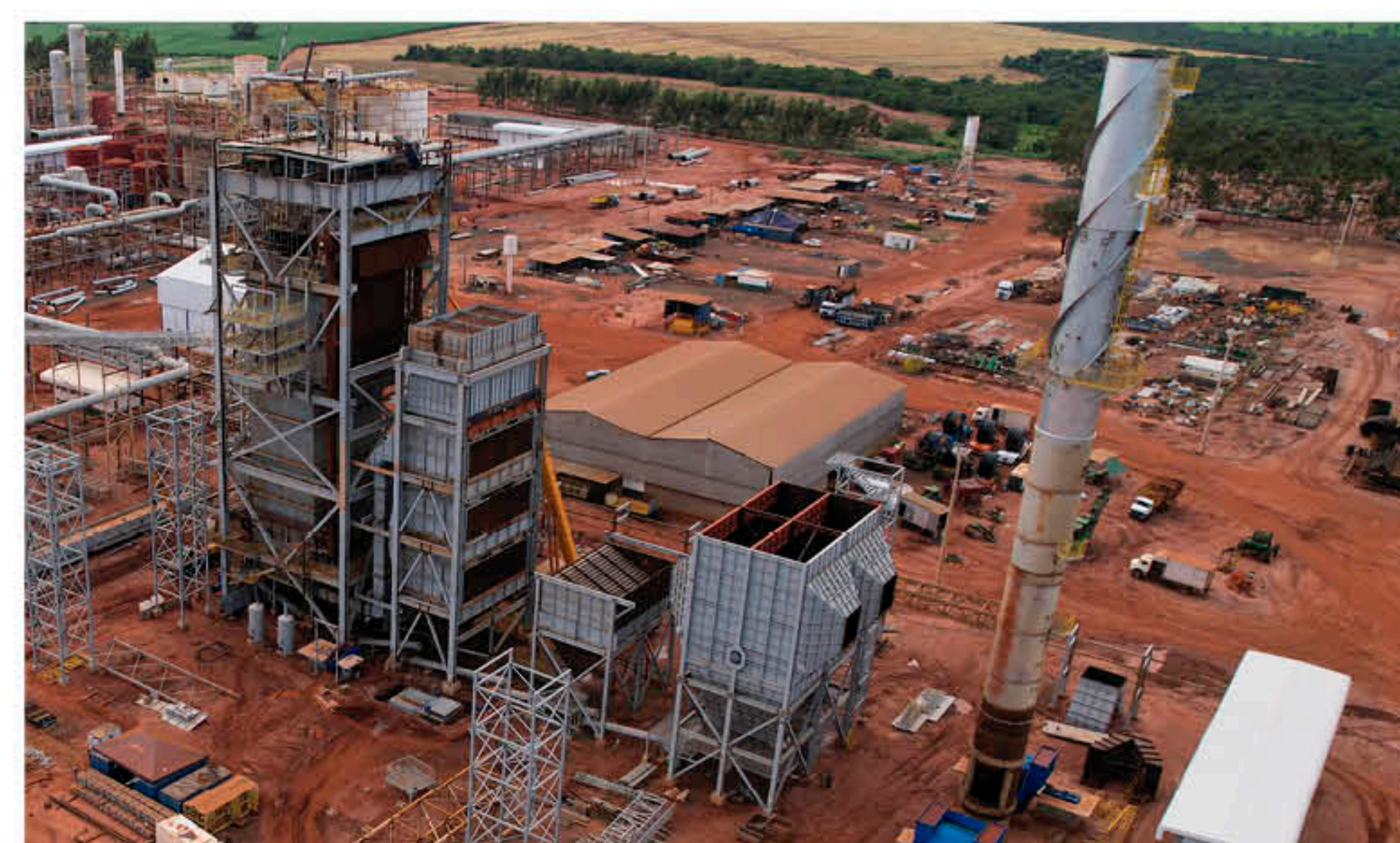
Caldeira que produzirá o vapor a ser utilizado tanto no processo industrial, quanto na cogeração de energia elétrica.
